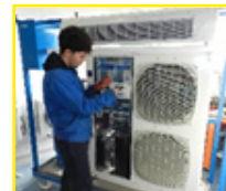
Maintenance et Efficacité Énergétique
